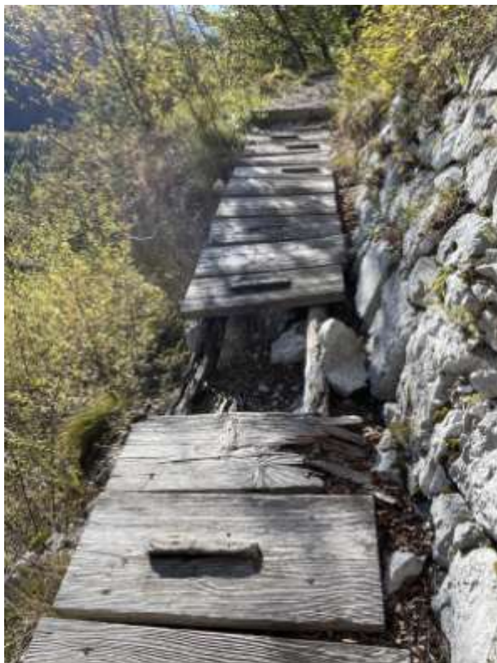
Slika: razpadajoči premostitveni objekt na poti proti Globoškemu potoku
